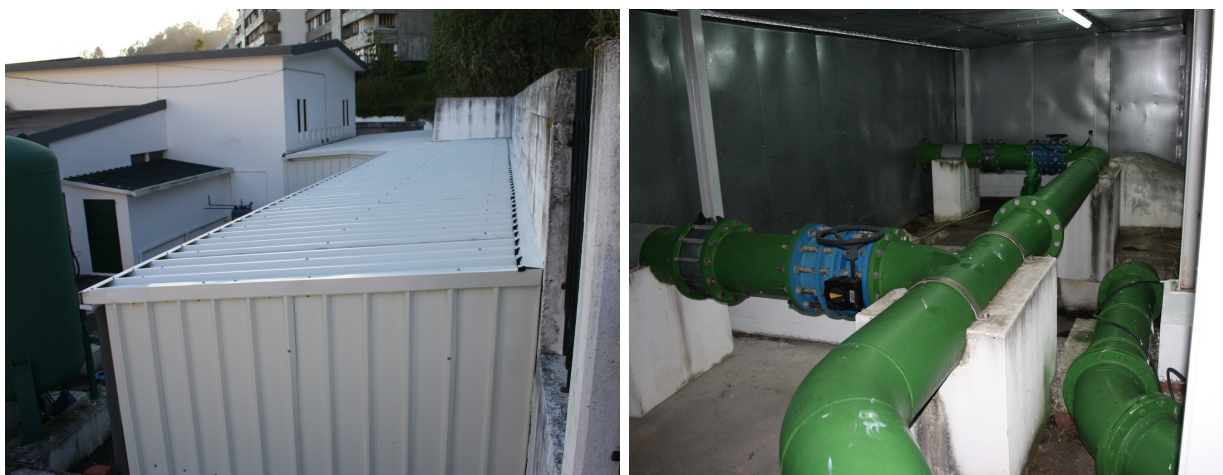
Figura 8 – Vista exterior e interior da “capotagem” aplicada nas condutas de abastecimento (a jusante das bombas e anteriormente no exterior).
