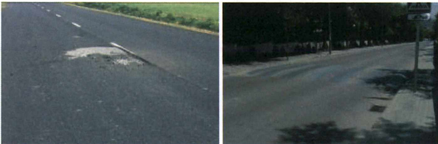
Figura 8.16. Diferentes tipo de discontinuidades: Izquierda desprendimiento de capa de rodadura-derecha resalto en vía urbana
