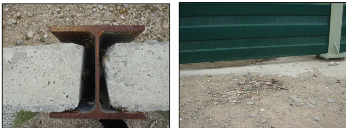
Figuras 6 y 7 – Incorreto sellado de juntas
