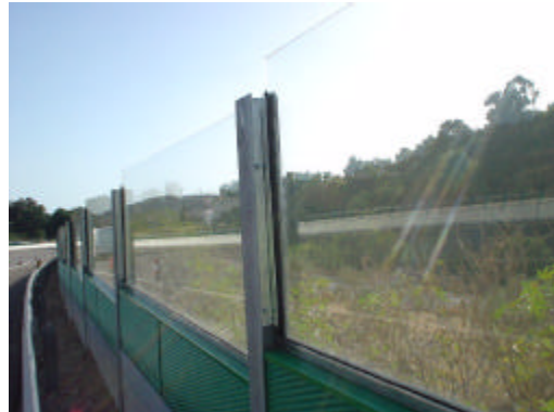
Fig.15 Pantallas mixtas (hormigón+metálica absorbente+acrílica reflectante)
