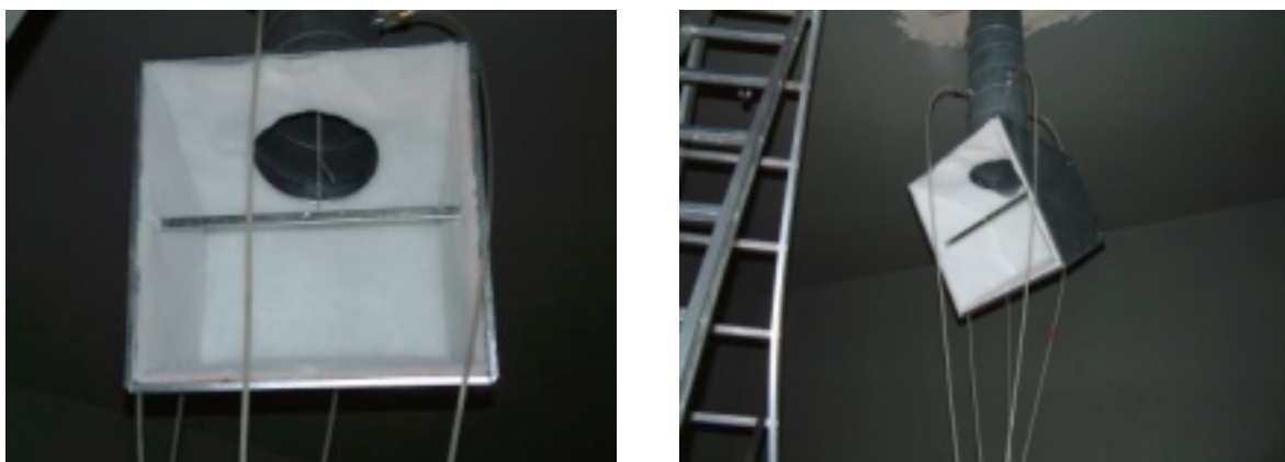
Figura 2 – Plenum recubierto de lana de poliéster.
