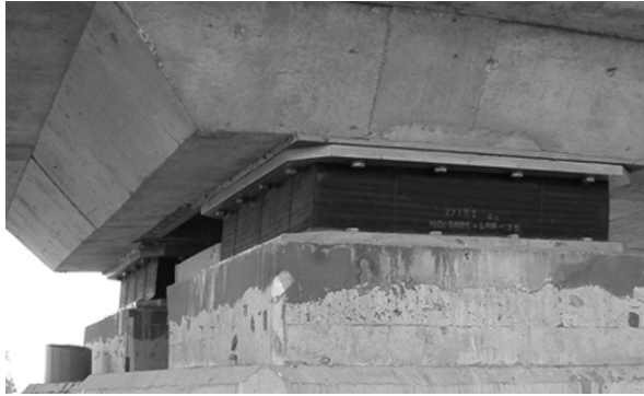
Figura IV.17. Disposición de capas elásticas en soportes de Edificios para atenuación de vibraciones
