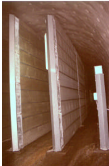
Vistas de los paneles acústico-absorbentes.
