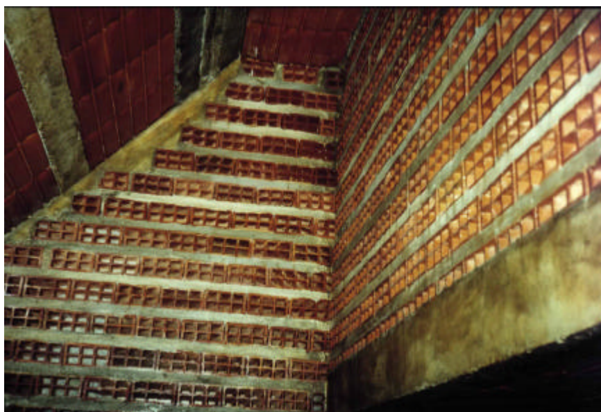
FOTO C: Vista de la entrada de aire al banco de prueba de ensayo de turbinas.
