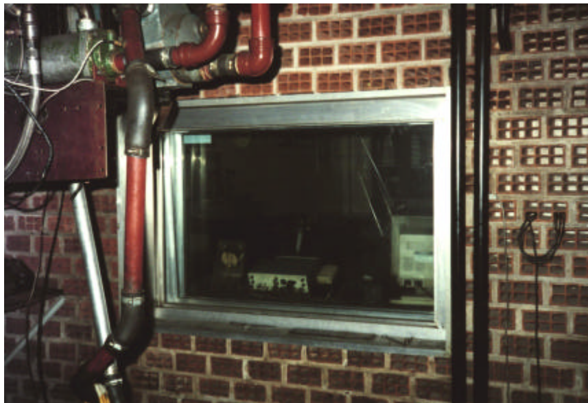
FOTO A: En la fotografía A se observa en el marco la instalación de los tres vidrios y la pared con los orificios que producen el efecto descrito.
