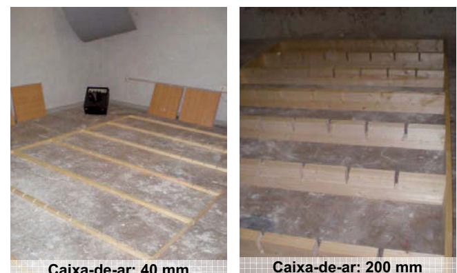
Figura 11. Estruturas de suporte dos painéis.
