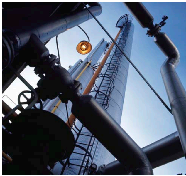
Imagen 1. Tuberías de gas en una instalación industrial.
