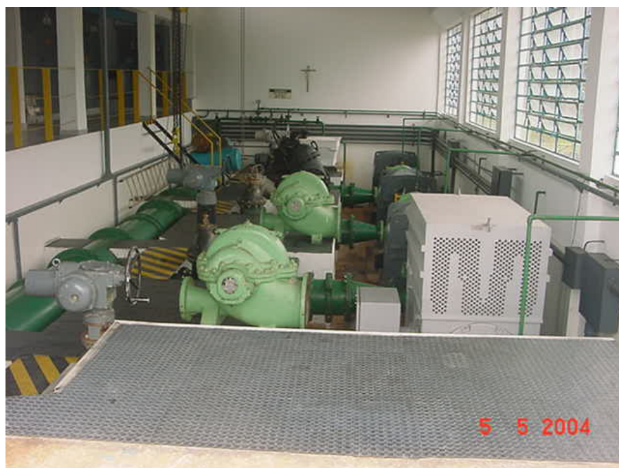
Figura 6. Captação Rio Una, vista dos conjuntos – Taubaté
