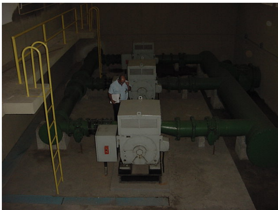
Figura 2. Estação Elevatória de Água tratada Indústria, vista dos conjuntos - São José dos Campos
