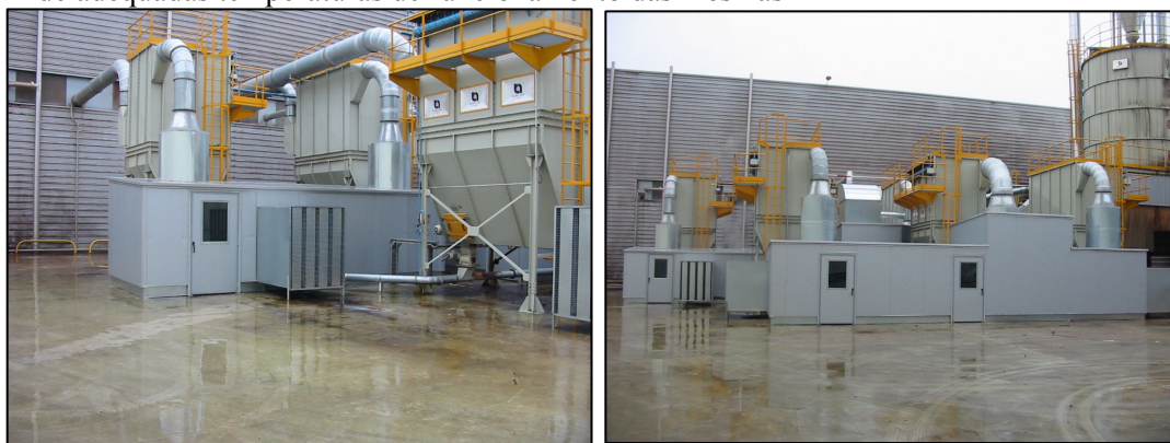
Figura 8 – Cabines insonorizantes de sistemas de despoeiramento
