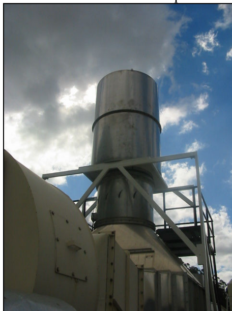
Figura 6 – Atenuador sonoro de saída de vapor
