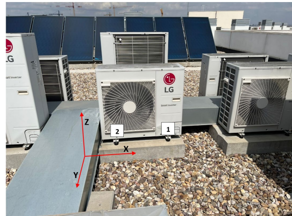
Figura 3. Vista general de unidad exterior de la máquina de aire acondicionado.
