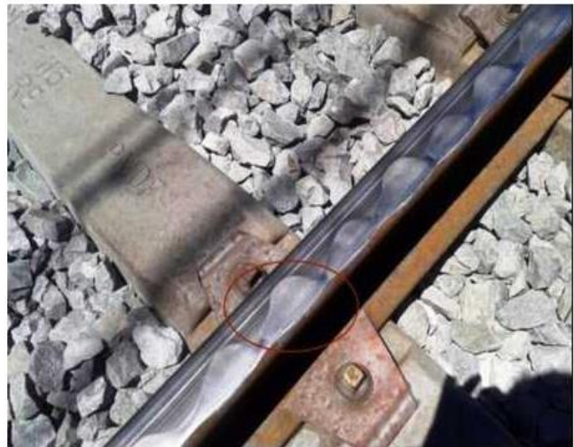
Figura 5. Desgaste ondulatorio en un raíl.
