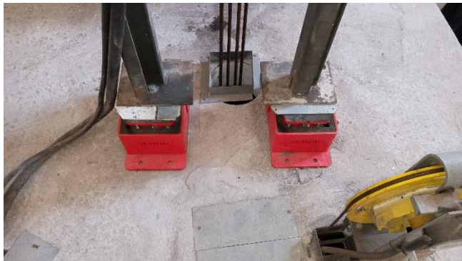
Figura 4. Apoyos elásticos instalados a posteriori en el grupo tractor de un ascensor tradicional. Se aprecia en la esquina inferior derecha que el sistema paracaídas no dispone de apoyos, creando un punto de transmisión de vibraciones a la estructura.
