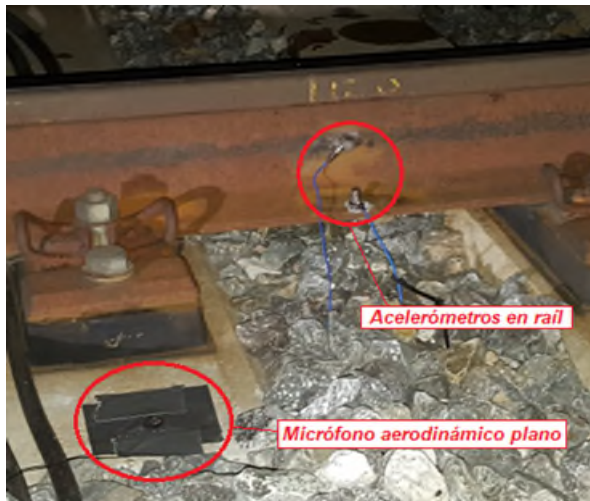
Figura 4. Instrumentación vibro-acústica en campo cercano utilizando un micrófono comercial plano instalado en la traviesa de una línea de alta velocidad, combinado con acelerómetros instalados en el raíl [2].
