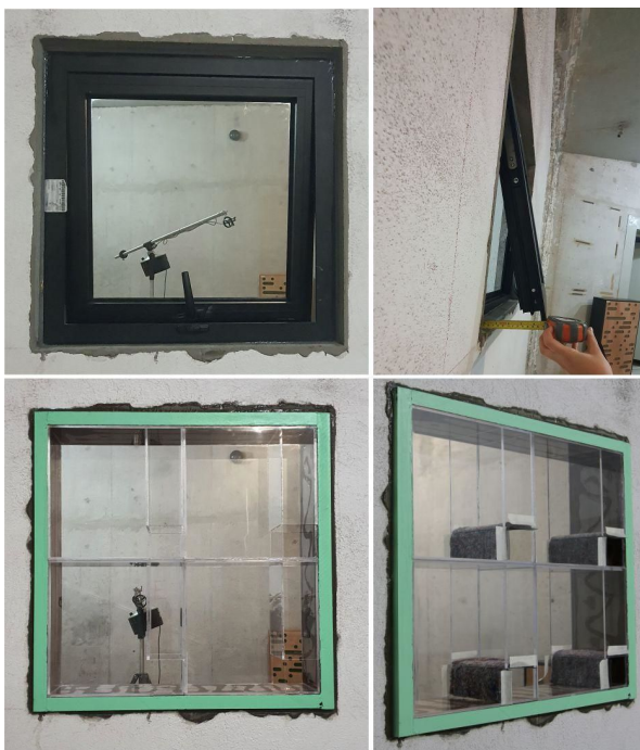
Figura 3. Ventanas colocadas en vano: a) Ventana pivotante: cerrada y abierta b) Estructura de metaventana: mm1.
