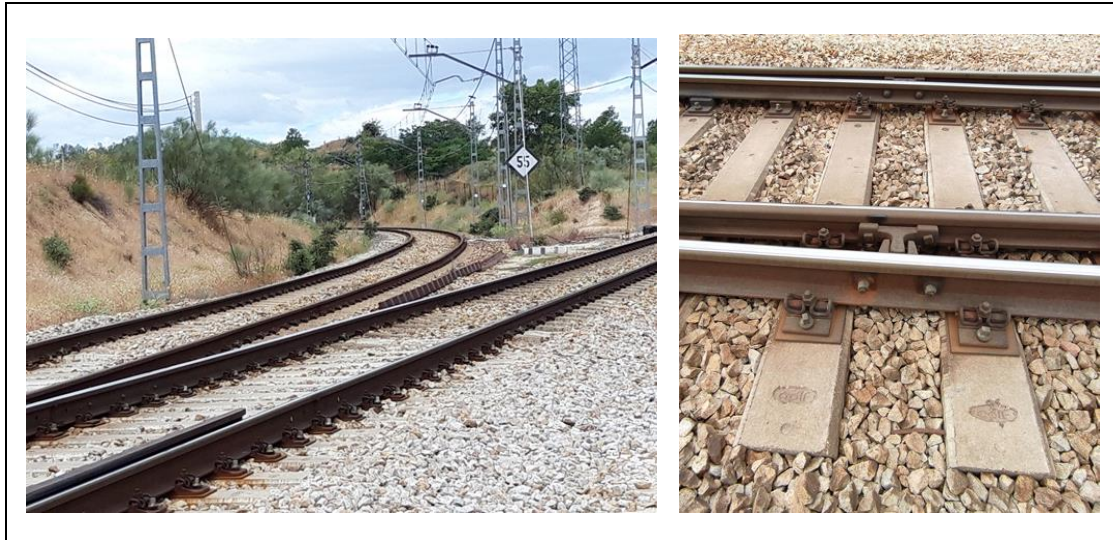
Figura 6 – Ejemplo de desvío que genera un ruido de impacto.
