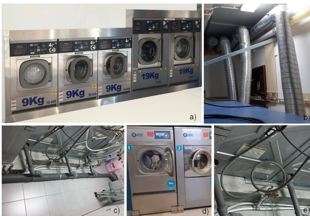
Figura 1: Imagens do interior de lavandarias “self-service” (das máquinas de lavar, saídas de extração de ar das máquinas de secar roupa, ligação do esgoto e base de apoio das máquinas).
