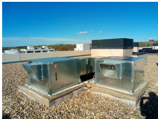
Figura 3. Imagen de los ventiladores ubicados en cubierta
