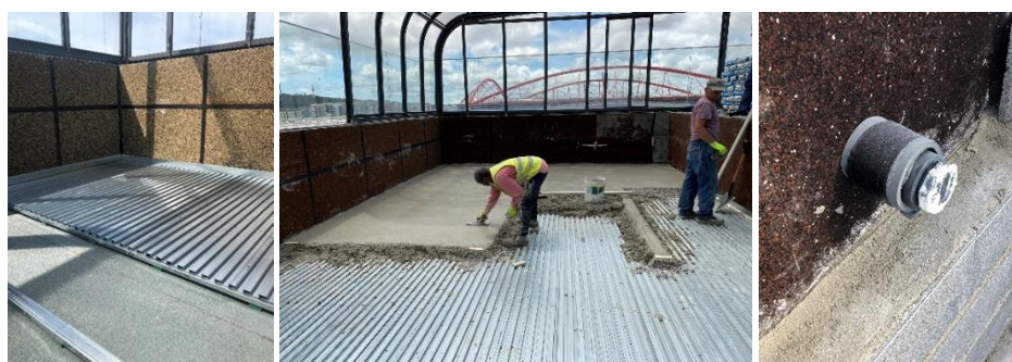
Figura 17 – (Esquerda) Instalação dos sistemas Stravifloor Deck e Stravibase Lateral. (Centro) Betonagem da laje flutuante. (Direita) Pormenor de isolamento de infraestrutura de apoio ao funcionamento da piscina.
