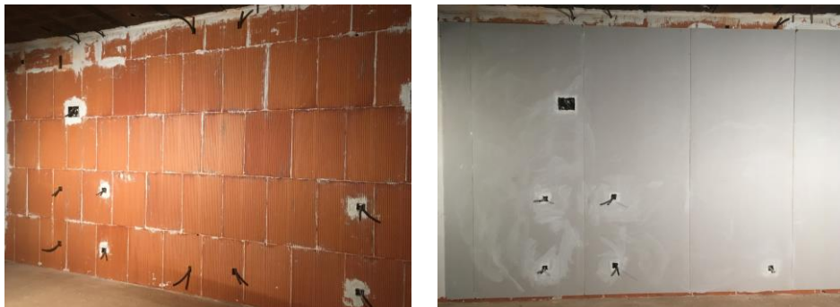
Figura 11 – Incorporación de los tubos y cajas para las instalaciones de electricidad en la pared sin revestir y con la placa de yeso laminado
