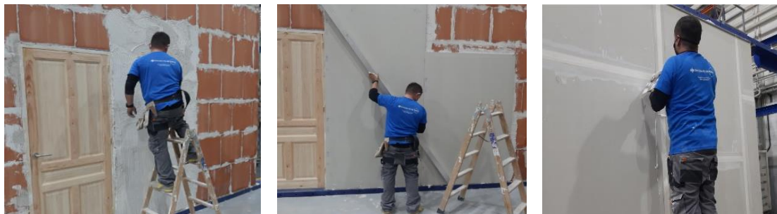
Figura 12 - Puesta en obra del revestimiento de placa de yeso laminado: aplicación de pasta de agarre sobre la fábrica, colocación de la placa de yeso laminado ajustando su planeidad y tratamiento de juntas.
