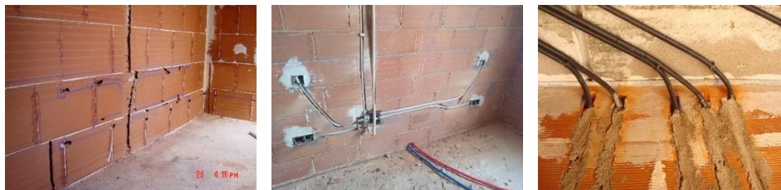
Figura 3 – Ejecución en obra de paredes de ladrillo gran formato con rozas e instalaciones
