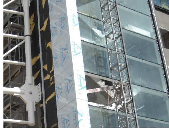
Fijaciones que han roto el revestimiento de la lana
