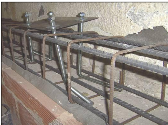
Figura 9. Malla para la construcción de las zapatas y anclajes para la pletina metálica antes de ser embebidos.
