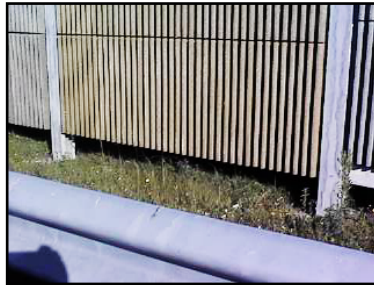
Figura 11 – Deficiente selagem dos painéis
