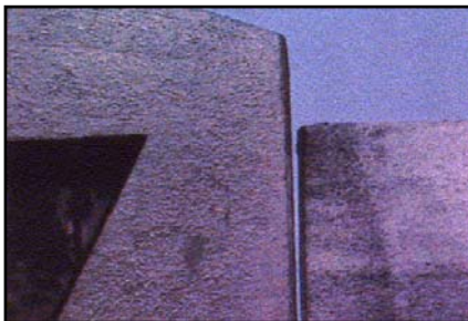
Figura 12 – Juntas mal seladas
