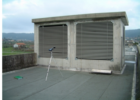
Figura 2 - Fotografia das saídas de ar posicionadas na cobertura
