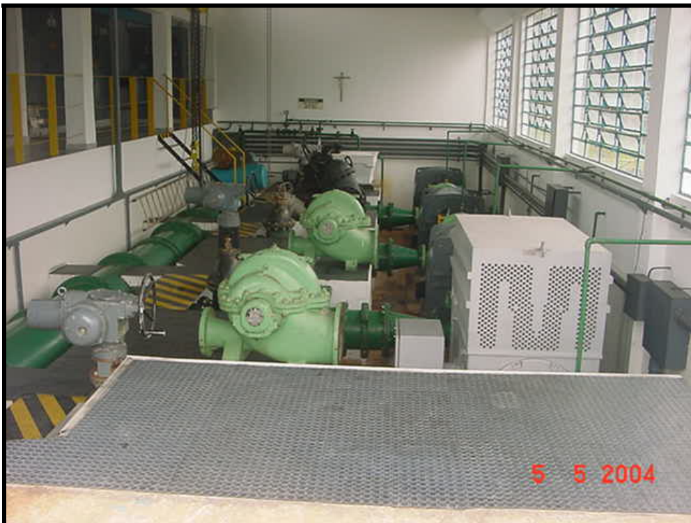
Figura 3: Casa de Bombas da Estação Elevatória de Água Bruta – Taubaté
