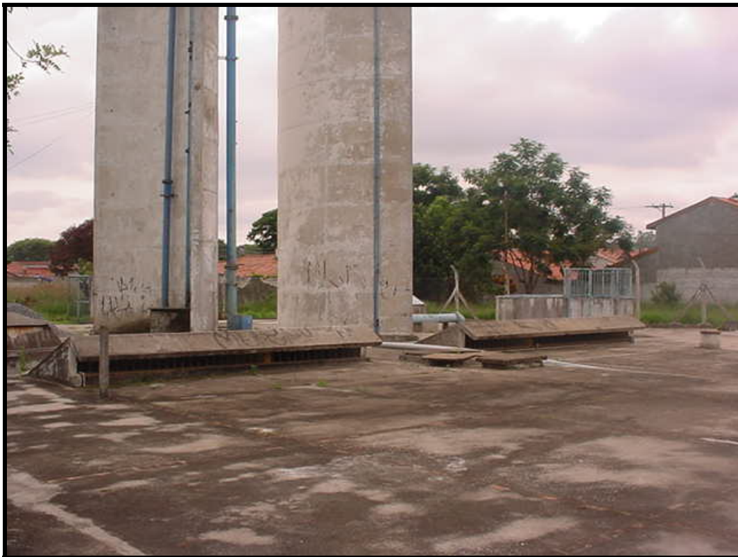
Figura 4: Estação Elevatória de Água Tratada do Bairro Vista Verde no Município de São José dos Campos – Área de Reservatórios
