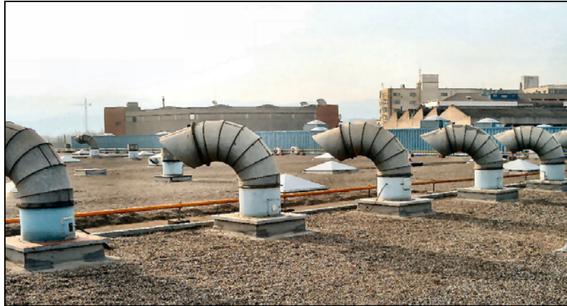
Figura 1. Cubierta de la nave industrial, con los ventiladores y conductos de expulsión objeto del ensayo
